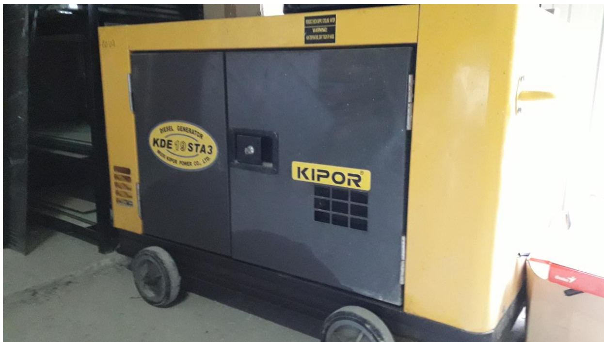
Stație electrică KIPOR KDE19STA3 (17kVA):
